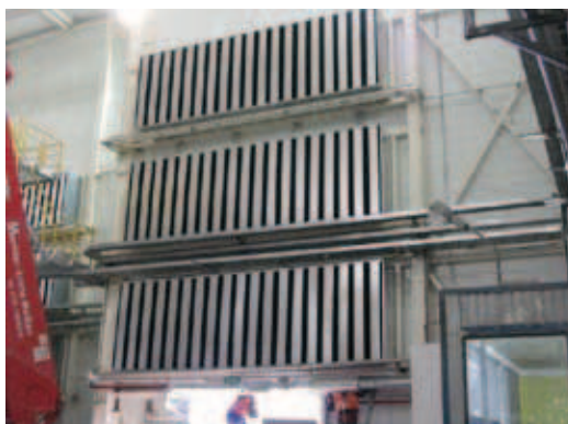
Fot. 5 Tłumiki akustyczne na czerpniach ściennych żaluzjowych
