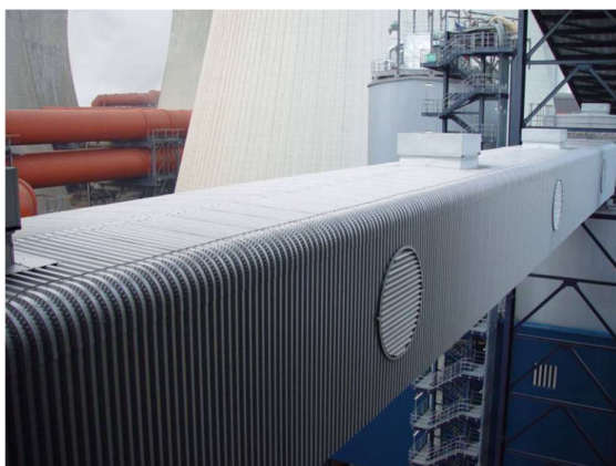
Taśmociąg do transportu węgla Elektrownia Niederausem
