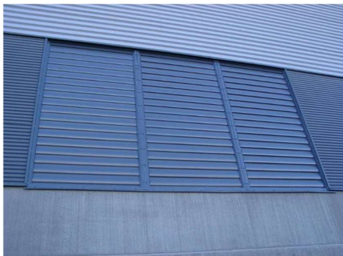
Czerpnia ścienna w Elektrowni w Bitterfeld
